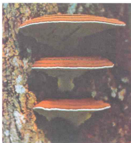
Разрушение древесины трутовиками
